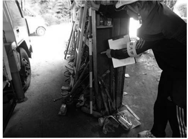
写真 2. 1. 4-67 ④工場内の浸水痕跡
