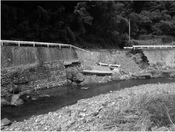
写真 2. 1. 4-74 ③湾曲部外側の護岸崩壊
