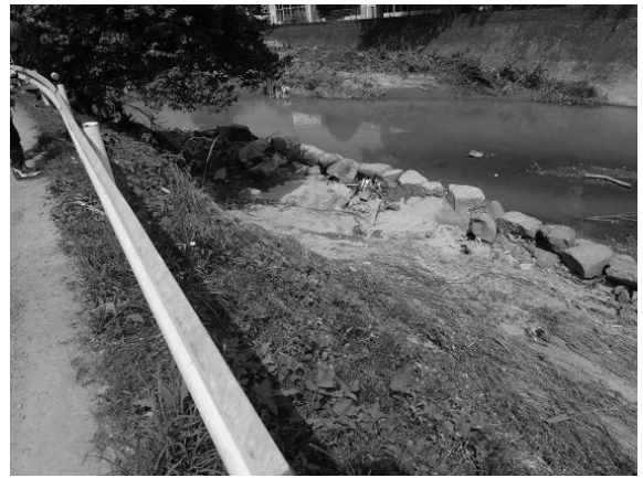
写真 2. 1. 4-20 ⑤立間橋右岸上流護岸の洗掘
