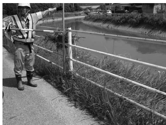
写真 2.1.4-4 ⑤右岸の浸水痕跡
