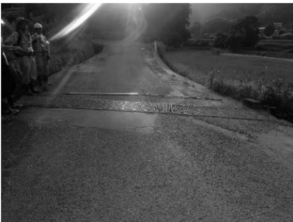
写真 2. 1. 4-50 ⑦鏡川橋右岸上流浸水範囲
