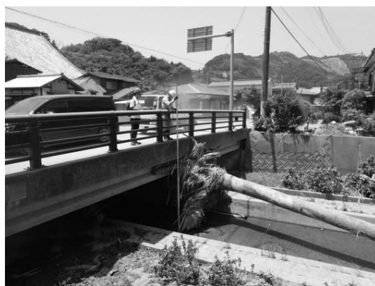
写真 2.1.4-12 ⑥御殿橋上流側の流木
