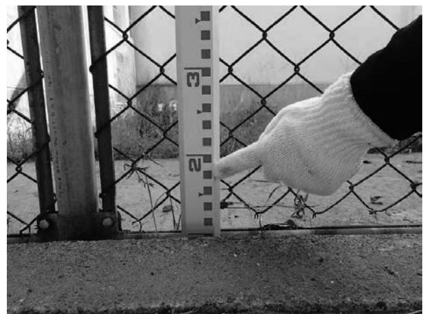
写真 2.1.4-40 ⑧松陰小学校の東側フェンス
