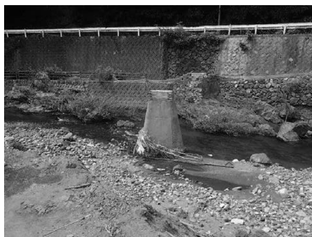
写真 2.1.4-73 ② 流失した弁天橋
