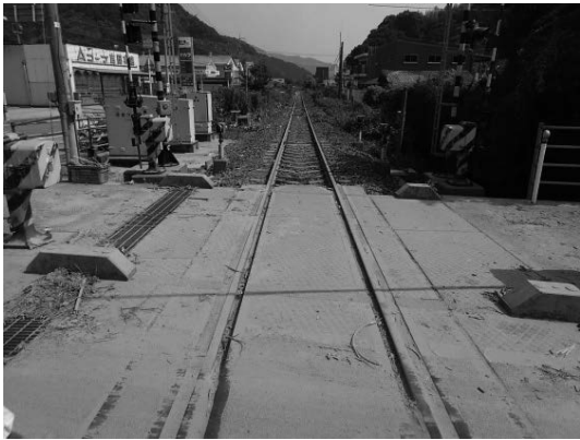
写真 2. 1. 4-23 ③蔭第 1 踏切の土砂
