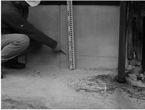
写真 2. 1. 4-76 ⑤宇治橋右岸の浸水痕跡
